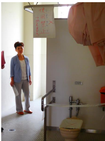
使用禁止のトイレ(北大津養護学校)
